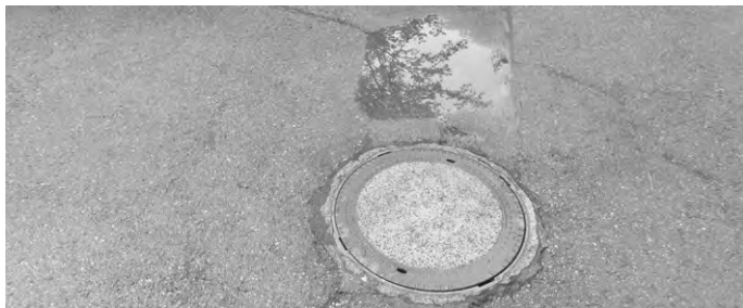
Sichtbare Schäden an den Deckbelägen
